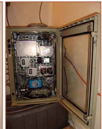
Armoire de mesure installée dans un hâloir
